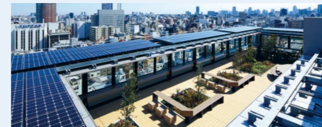
本社ビル屋上に設置した太陽光パネル
