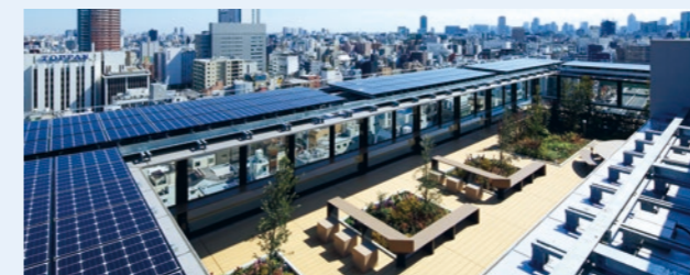
本社ビル屋上に設置した太陽光パネル
