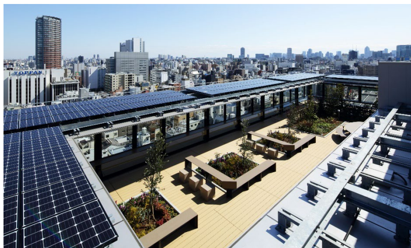
＜本社屋上設置の太陽光パネル＞
