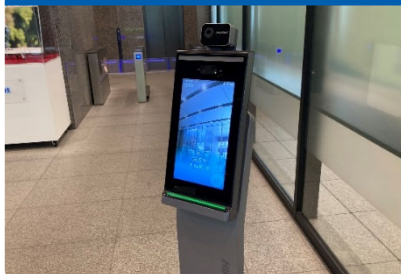
検温器を設置
